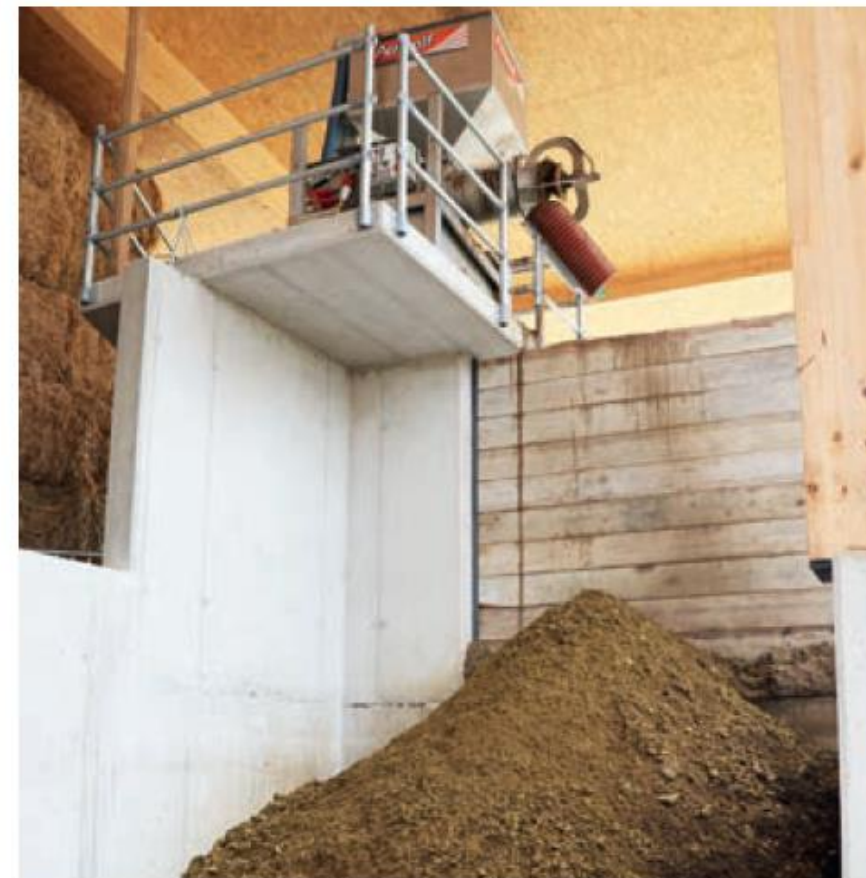
Stationärer Separator mit befestigtem, überdachtem Lager.
